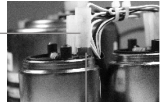
2. Conector mal posicionado.
